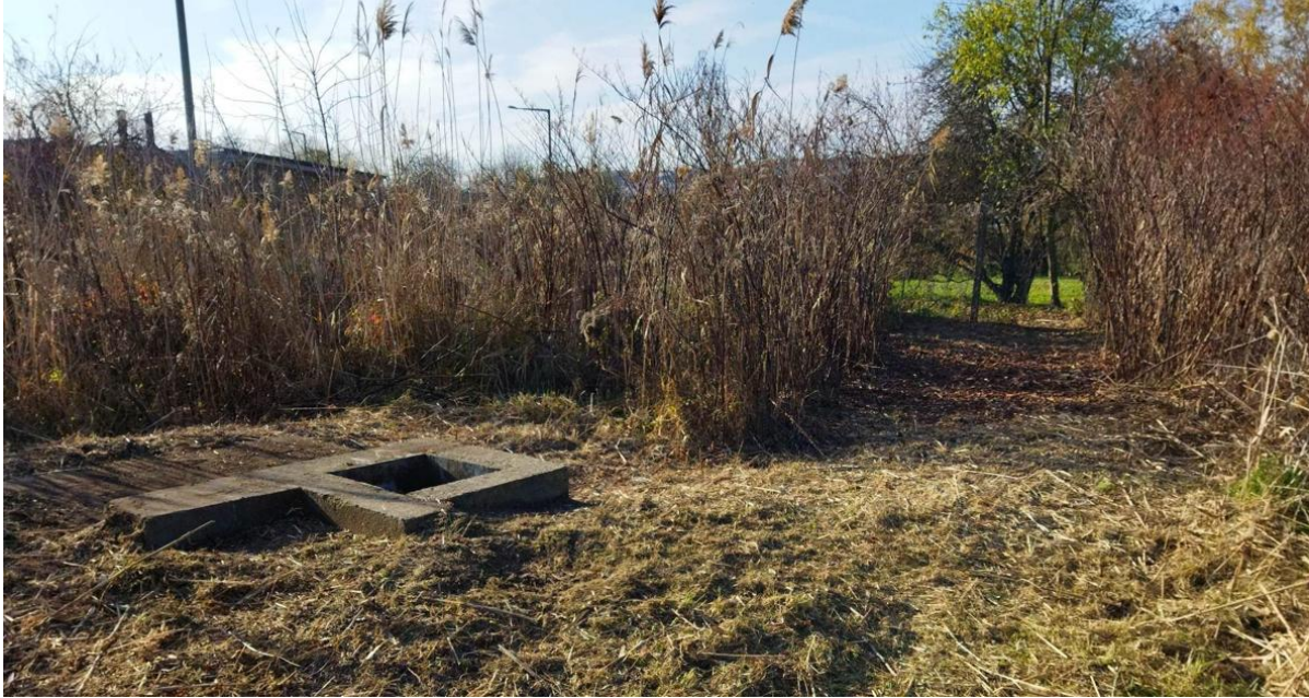
59. ábra: Vízkormányzási műtárgy a kibocsátási pont előtt
