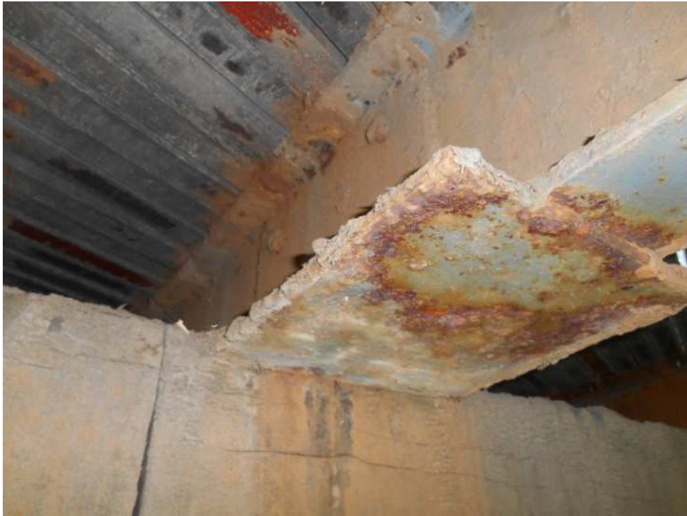
17. Acél felületeken előrehaladott korrózió
