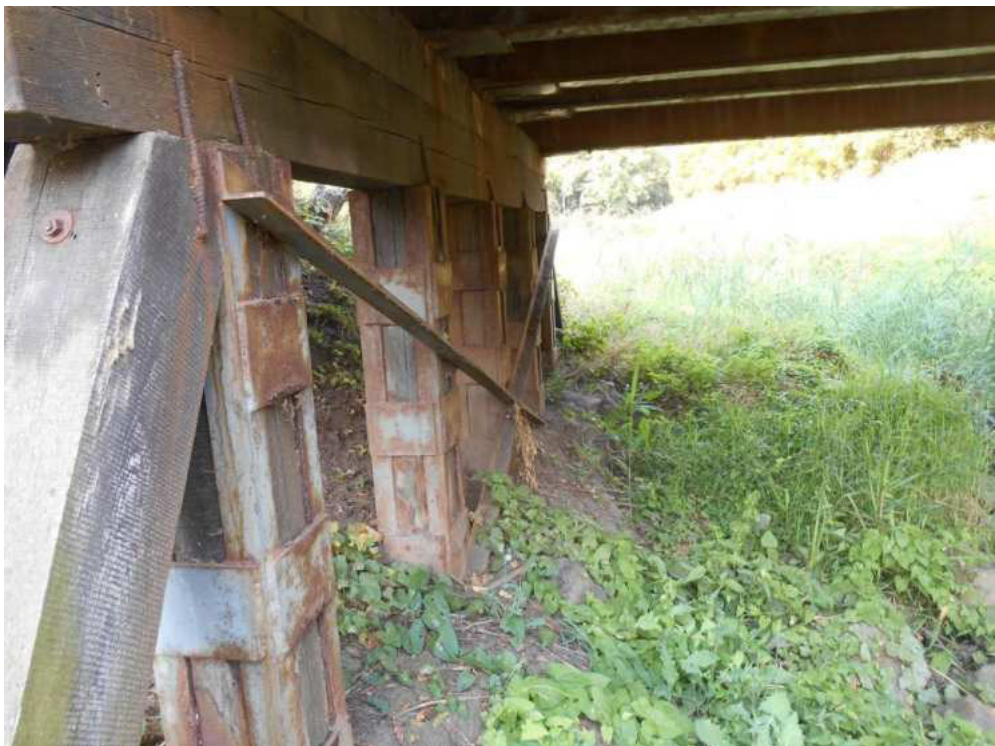
2. Jobb parti korrodált pillérek
