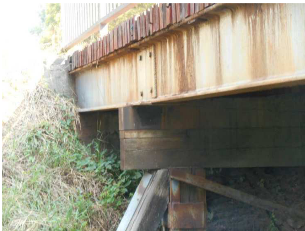
12. Bal parti szélső pillér. Korrózió a főtartón
