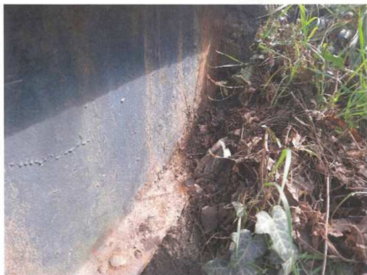
Szélső főtartón rozsdásodás, mivel talaj, növényzet rakódott rá
