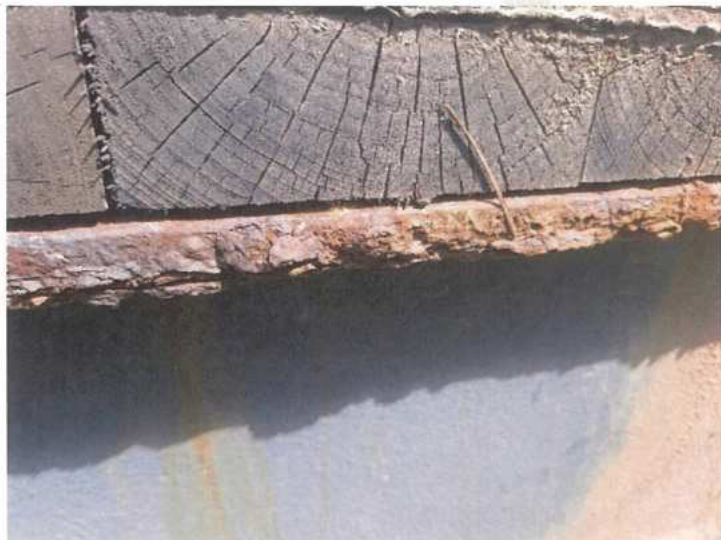
Lemezes rozsdásodás a főtartó felső övé
