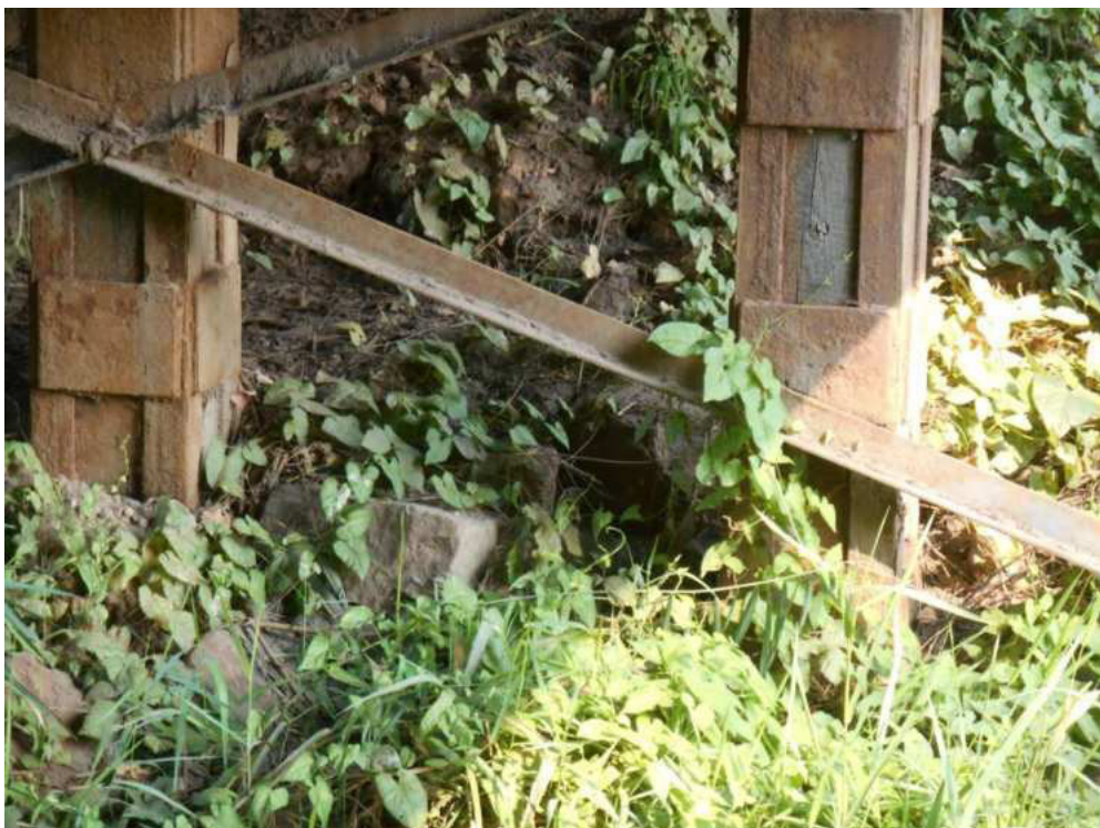
8. A pillérek közelebbről. Az acélszerkezetek rozsdásak
