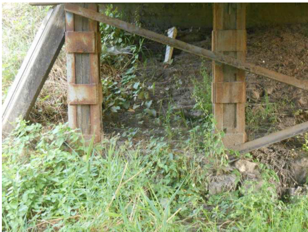
13. Bal parti korrodált pillérek
