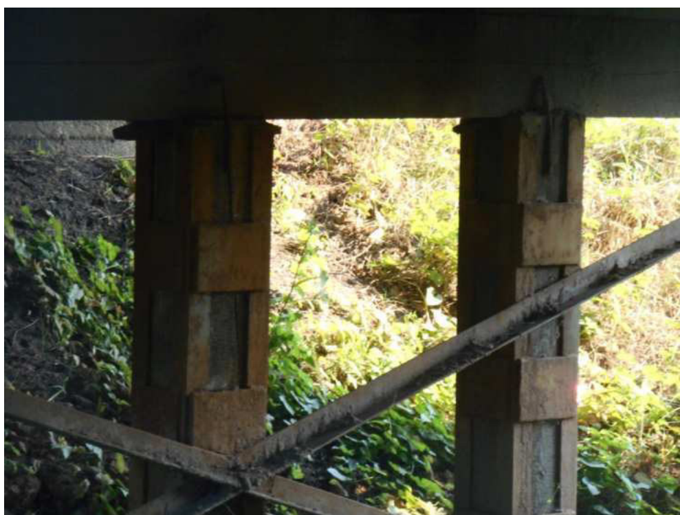
14. Korrózió az acélszerkezeteken
