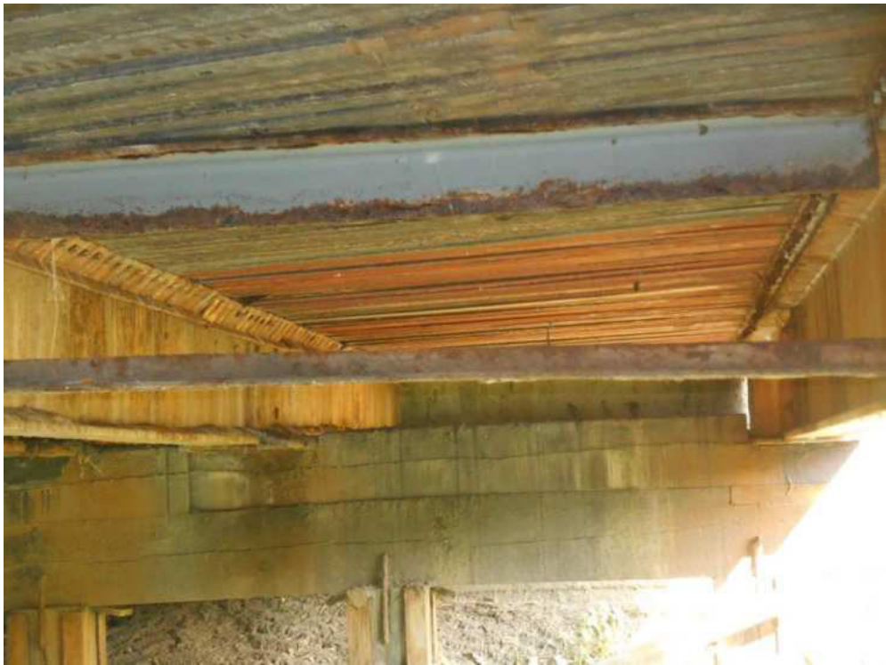
15. Felszerkezet. Acél főtartók rozsdásak
