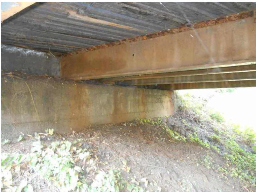
6. Jobb parti hídfőn vízfolyások, korrózió, rozsdás főtartók
